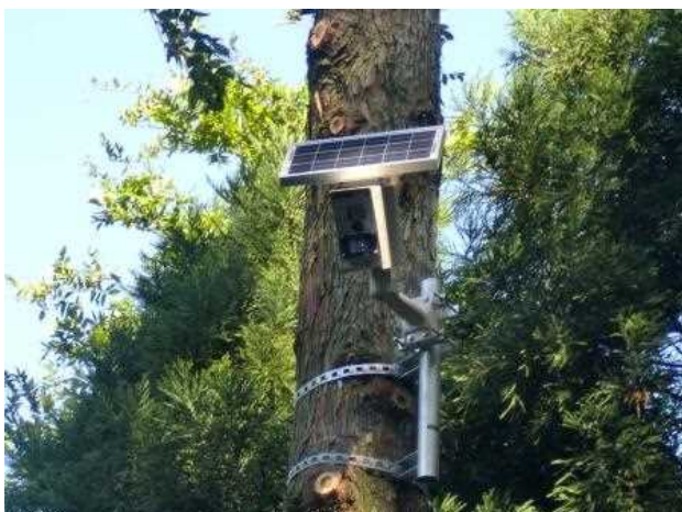
図 7-3-1 市内に設置している監視カメラ
