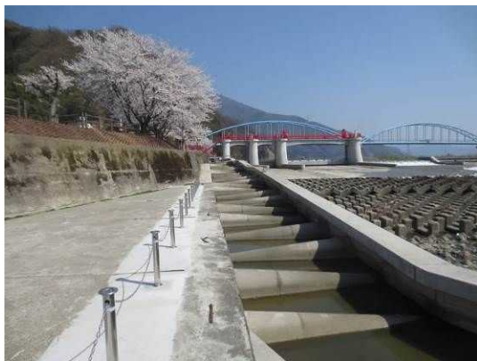
松ヶ鼻頭首工に設置された魚道
