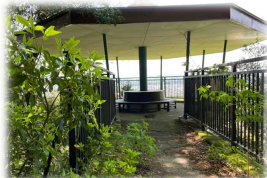
ビューポイントの魅力向上 (八角展望台の塗装改修、雑木剪定等)
