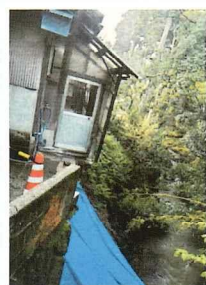
大雨で災害を受けた民家 上吉野瀬川斜面崩壊部の改修工事決定
