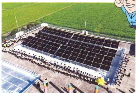
▲南中山小学校 太陽光発電設備
