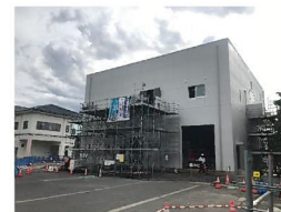
汚泥前処理施設
