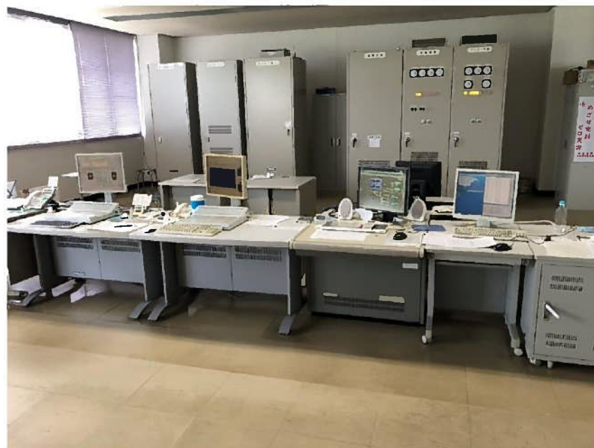
家久浄化センター3F 中央監視室
