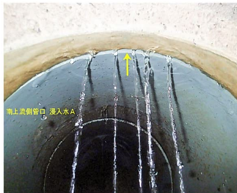
【MH】管口からの浸入水(緊急度I)
