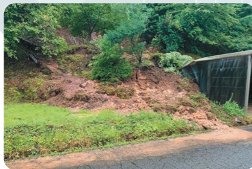
令和6年6月大雨による土砂崩れ(高瀬谷町)
