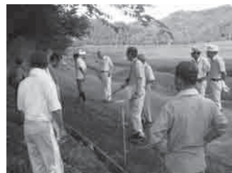
電気柵の設置確認
