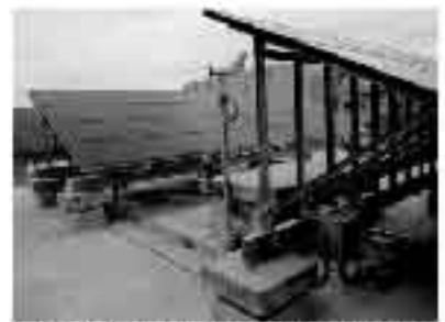
越前市中央図書館電気工事(当社施工) 地上設置太陽光発電システム
