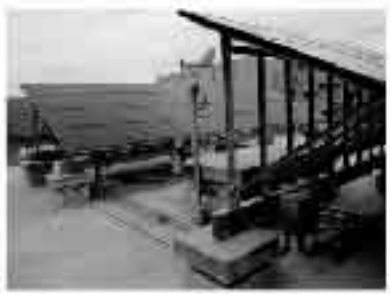
越前市中央図書館電気工事(当社施工) 植上設置太陽光発電システム
