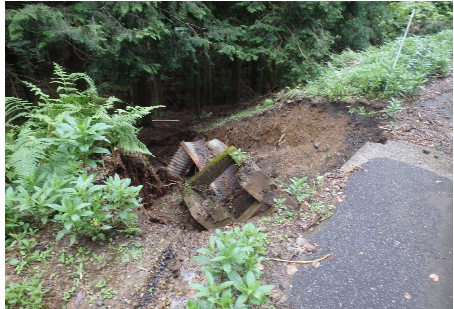
（被災した林道沿いの集水柵の様子）
