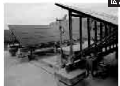
越前市中央図書館電気工事(当社施工) 屋上設置太陽光発電システム
